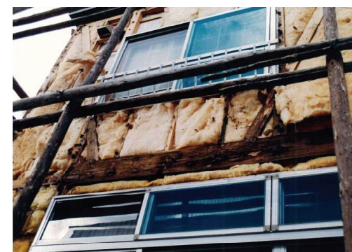
グラスウールが腐りずり落ち、木材も腐食している。
